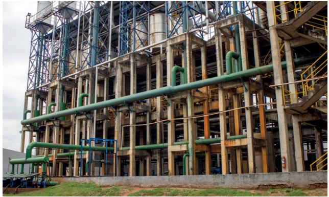
Verarbeitungsanlage bei Hibernia Misiones
